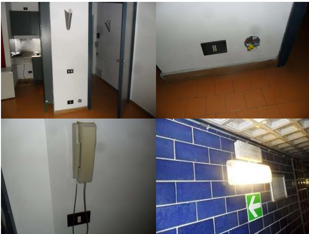
Alcune immagini degli impianti esistenti, camere e corridoi
